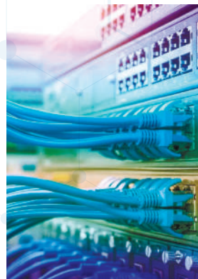
МОНТАЖ И ОБСЛУЖИВАНИЕ СЕТЕВОЙ ИНФРАСТРУКТУРЫ
